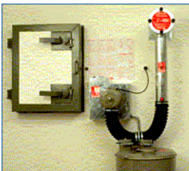
Lüftungsaggregat eines Schutzraumes
